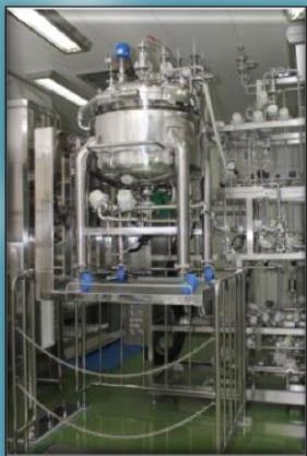
ろ過受けタンク
